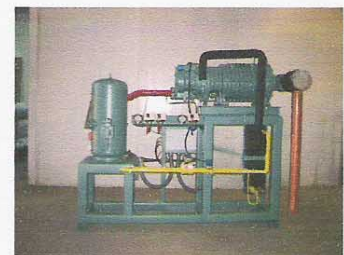
Rack de motocompresores
