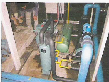
Enfriador de Agua (Chiller)
