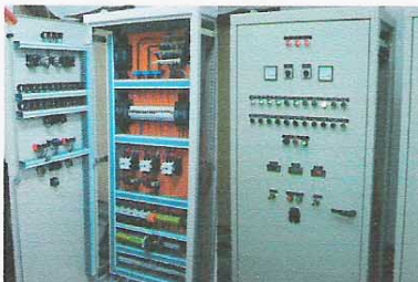
Panel eléctrico y de control
