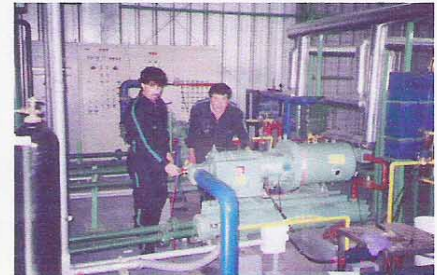
Chiller con entrador tornillo
